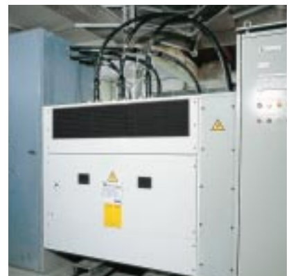
630 kVA - 20 kV/400 V
