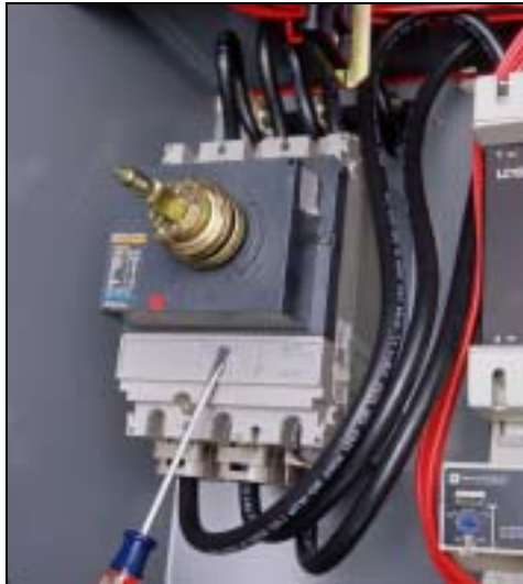
Figure 45 : Ajustement du déclencheur magnétique
