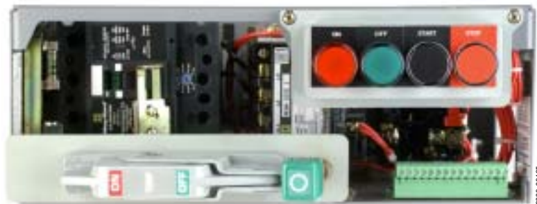
Figure 36 : Manette de commande du disjoncteur en position d'arrêt
