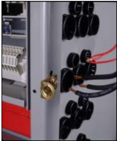
Figura 22: Pasahilos del conducto vertical para cables
