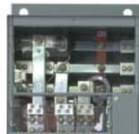
Figura 25: Compartimento de zapatas principales situado en la parte superior
