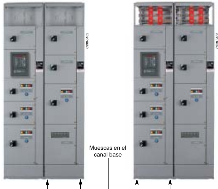
Figura 5: Conductos para cables horizontales (izquierda) con tapas retiradas y barreras de dos piezas del bus (derecha), retiradas
