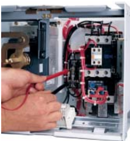
Figura 41: Revisión visual de los fusibles
