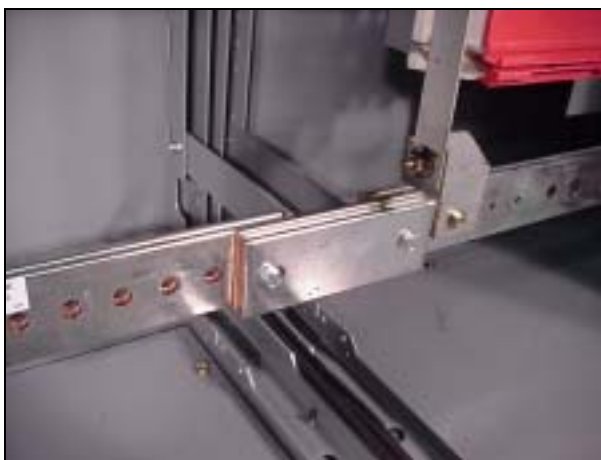
Figura 19: Tornillos de la barra de tierra, sustituidos
