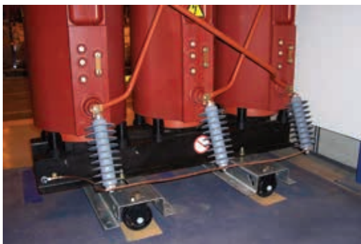
Autoválvulas de sobretensiones de alta tensión en la parte inferior
