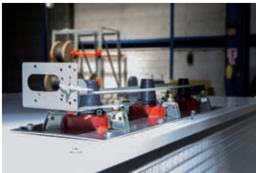
Conexiones de MT
