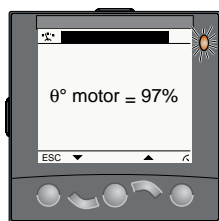
Alarma de imagen térmica.
